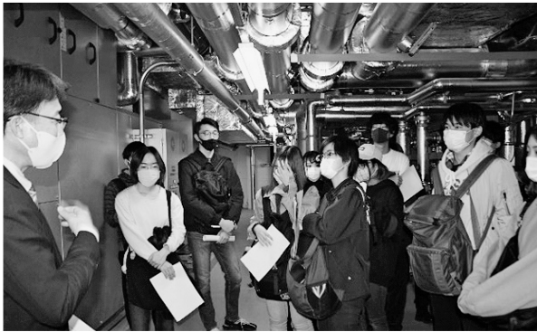
写真3 市庁舎機械室の見学
